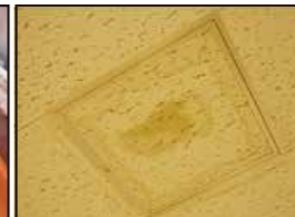
▲天井にできてしまった水漏れによるシミ。お肌と同じ…簡単には消せない。
